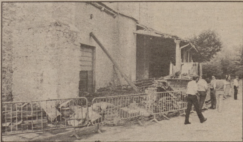
A la espera de que los técnicos hagan sus últimas inspecciones, el pórtico de Santa Marina sigue en pie, con el correspondiente riesgo. (Foto Kiñu)
